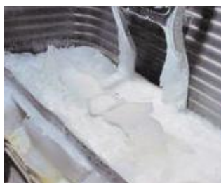
Tvorba ledu na venkovní jednotce bez topného kabelu
